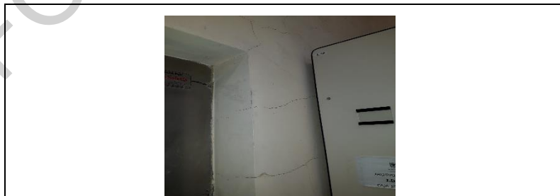
Registro fotográfico del archivo central que evidencia, fisuras y presencia de humedad, así mismo se carece de sistemas de filtración y circulación de aire
